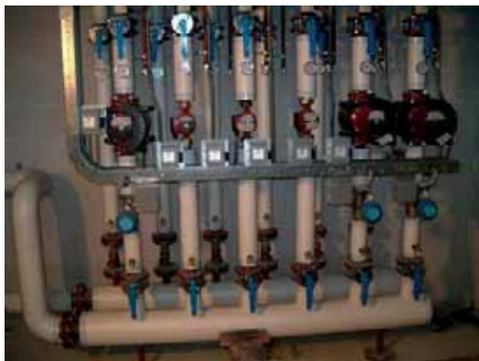
Techniek in beeld: warmtestation in souterrain
